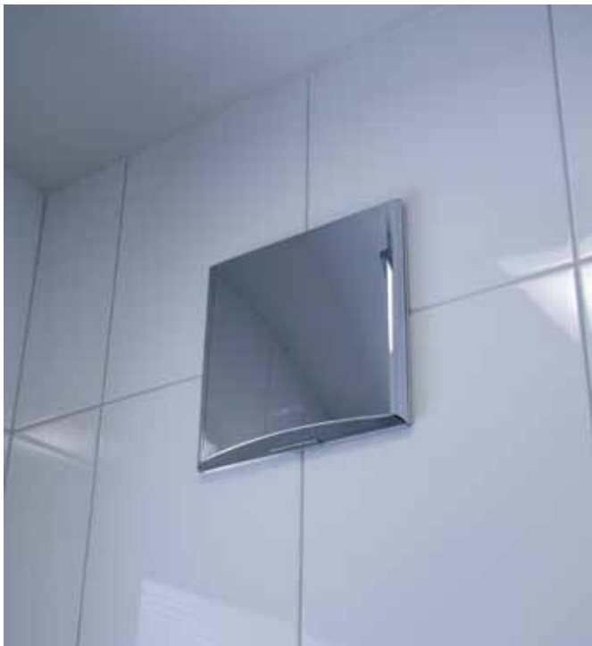
Zariadenie na odvod opotrebeného vzduchu „LIMODOR F/M“ s chrómovým krytom v sociálnych miestnostiach
